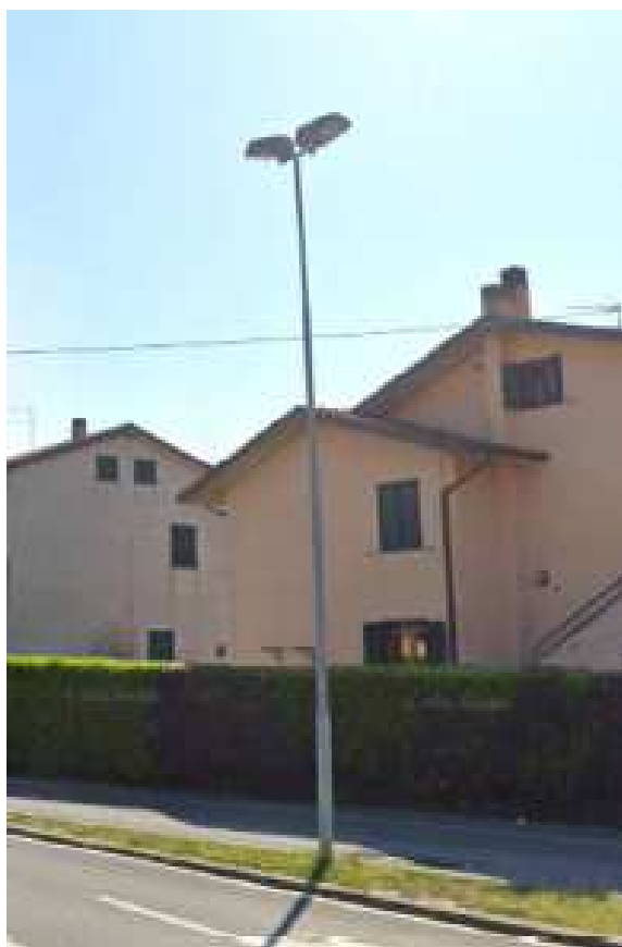
Figura 3 - Armatura stradale su testa palo dritto con due punti luce – tipo D
